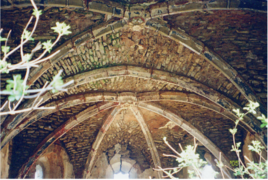
Der noch nicht eingestürzte Chorraum
